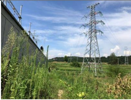
竹市 110kV 变电站 110kV 出线间隔侧
